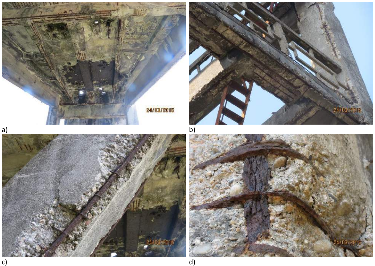
Figura 9 – Ilustração do estado atual de degradação da obra:
