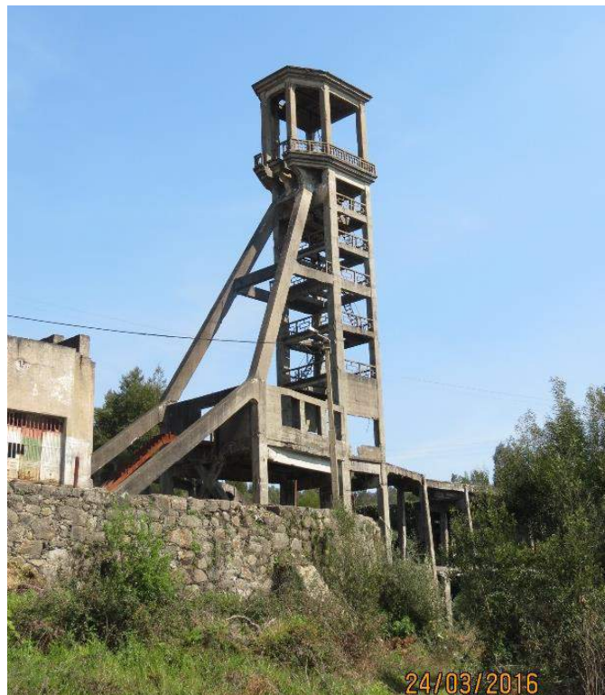
Figura 6 – Aspeto geral do estado de conservação do Cavalete de S. Vicente
