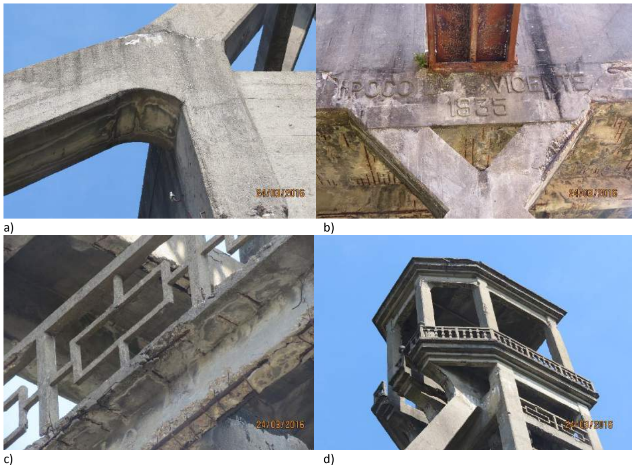
Figura 7 – Alguns aspetos de detalhe do estado de conservação da obra:
